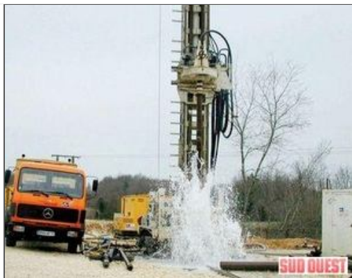
L'étalement des forages permet de mieux respecter l'équilibre prélèvements-renouvellement de la ressource. (photo « so »)
