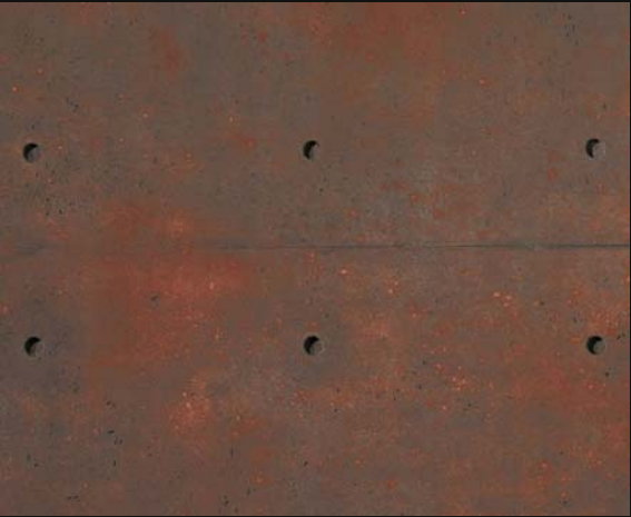
M-172 · Rusty Concrete Panel Panel Cemento Oxidado
